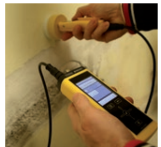
Lokalisierung des vom Wassereintritt betroffenen Bereichs mittels digitalem Feuchtigkeitsmesser
